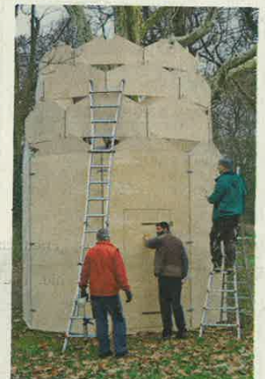
Am Freitag arbeiteten die Zimmerleute bereits an dem Dach, das einer Krone ähnlich ist.
